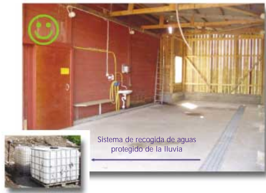
Figura 54. Ejemplo de instalación para el llenado y el lavado del equipo de tratamientos, con sistema de recogida de las aguas contaminadas (foto BAYER CROP SCIENCE DK)
