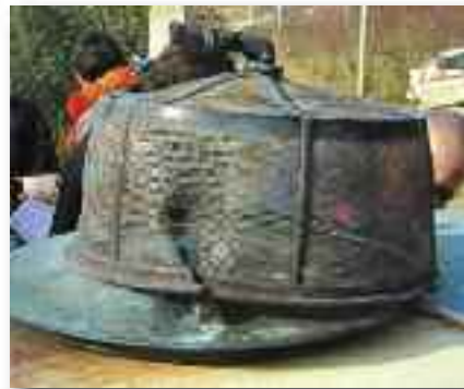
Filtro de llenado en condiciones claramente no aceptables
