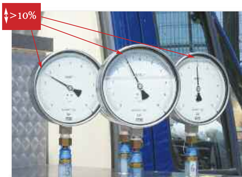
La colocación de un manómetro certificado conectado al inicio de cada sección de la barra nos permite comprobar si la variación de presión al cerrar y abrir sectores supera el límite del 10% tolerado
